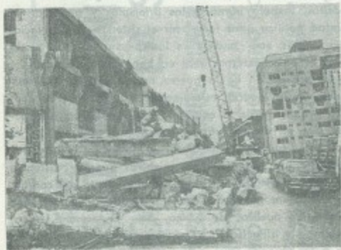
UN AÑO DEL SISMO, muchos edificios continúan en escombros. Este de la Alianza de Camioneros está en Edición y Serapio Rendón.
