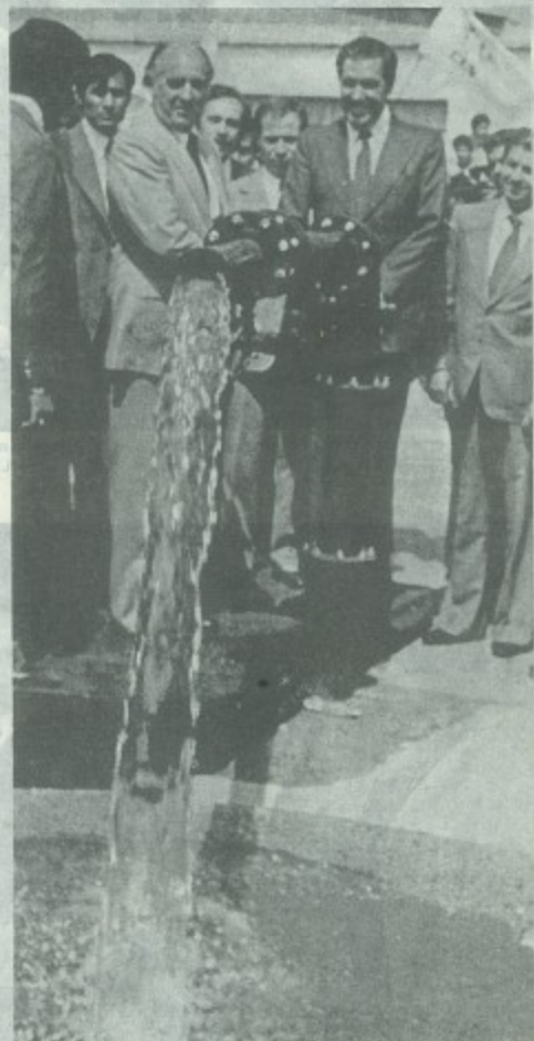
El Presidente de la República, licenciado José López Portillo, abre la válvula de una de las tomas de agua potable que integran la red de 90 kilómetros, construida por el DDF, Delegación Coyoacán. Lo acompaña el profesor Carlos Hank González, jefe del DDF.
