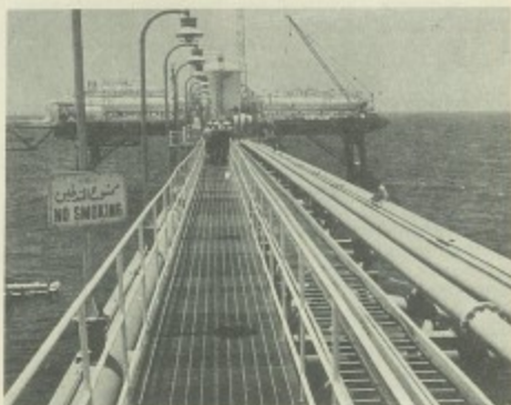
Las más modernas instalaciones de tuberías en el gigantesco muelle para cargar petróleo en los grandes barcos.
